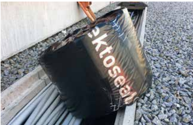
Rotoli su misura per una posa facile sia tra i binari che nei tratti esterni
