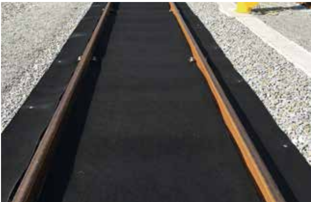
Posa del materiale terminata in modo da prevenire la contaminazione direttamente alla fonte
