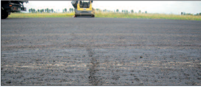
Figura 3 - La fessura di riflesso in corrispondenza del giunto
