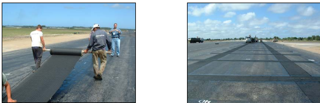
Figura 12 – Instalação da Geogrelha na pista do Aeroporto Internacional de Carrasco (2004).
