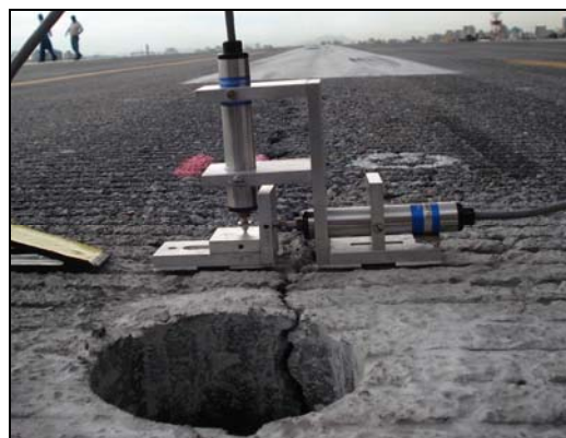
Figura 6: Medidor de deslocamento “Crack Activity Meter” (CAM) (Aeroporto de Congonhas, 2008).
