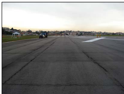
Figura 5: Reflexão das juntas na capa asfáltica (Aeroporto de Congonhas, 2008).
